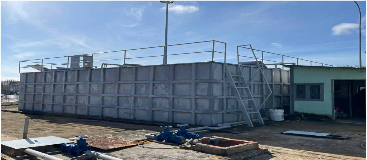
Hệ thống xử lý nước thải
