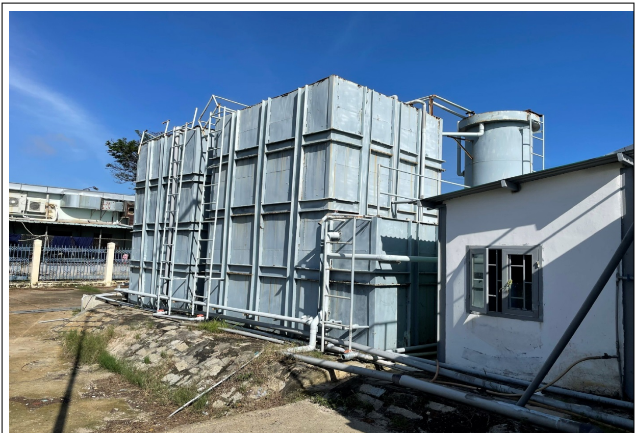
Hình 3. 1 Hệ thống xử lý nước thải
