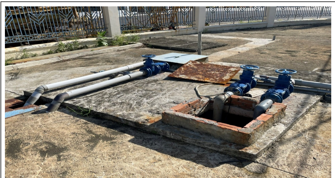
Hình 3. 4 Bể chứa nước thải dầu vào
