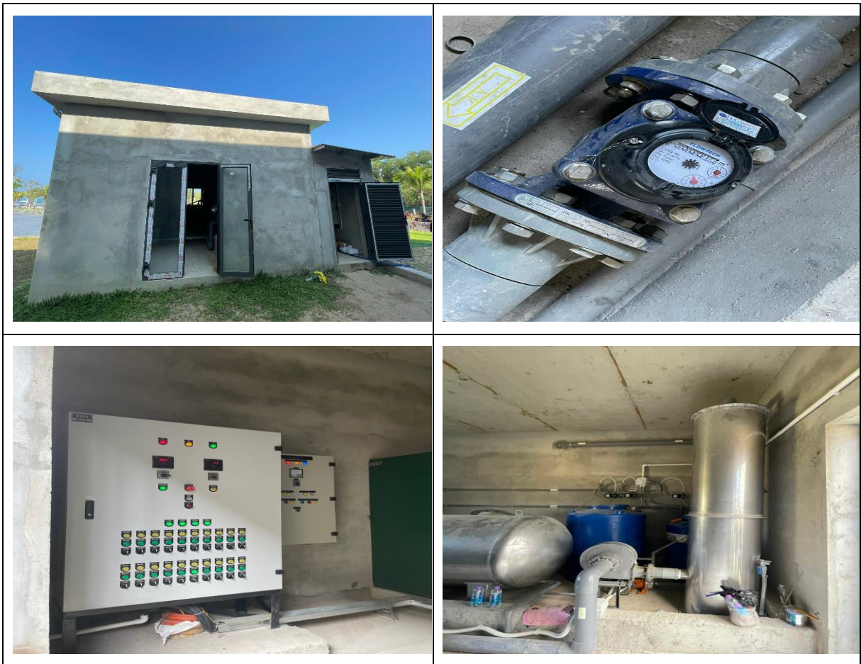
Hình 3.5. Một số hình ảnh tại hệ thống xử lý nước thải công suất 500m 3 /ngày.đêm của cơ sở
