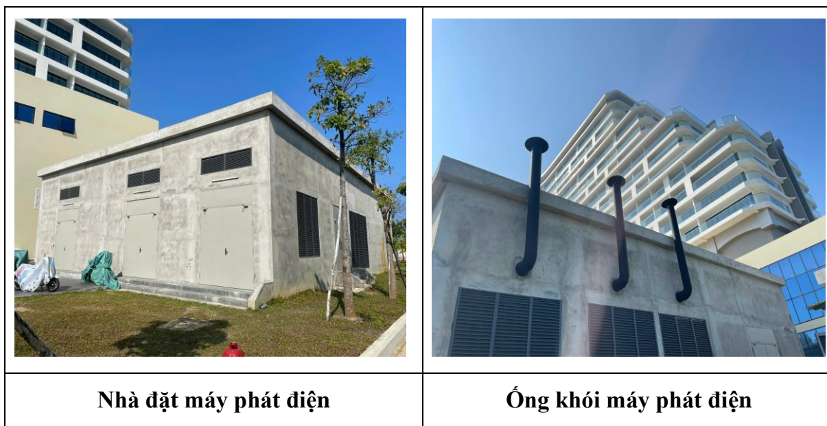
Hình 3.6. Khu vực đặt máy phát điện của cơ sở
