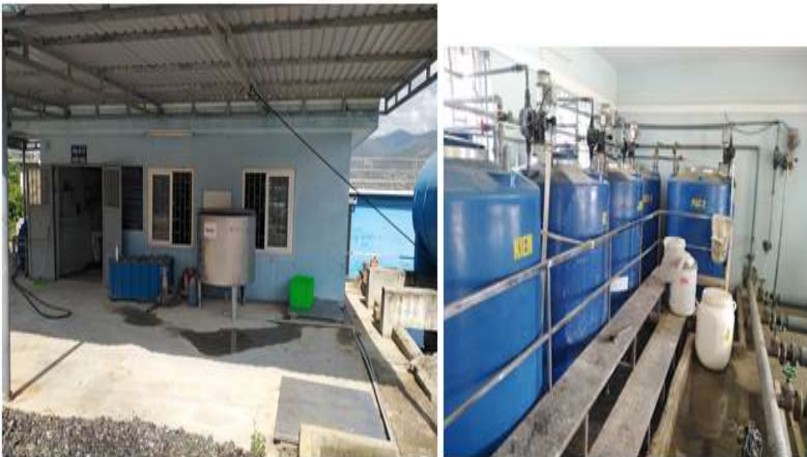
Hình 3.9: Nhà vận hành và các thùng hóa chất vận hành HTXLNT
