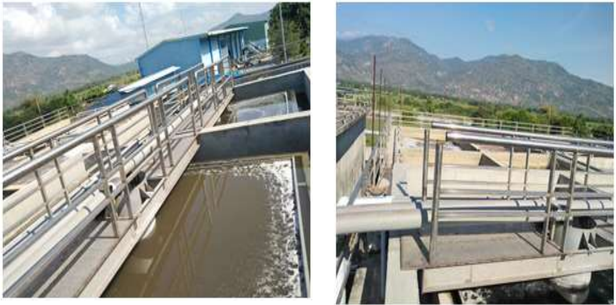
Hình 3.10: Các bể xử lý nước thải
