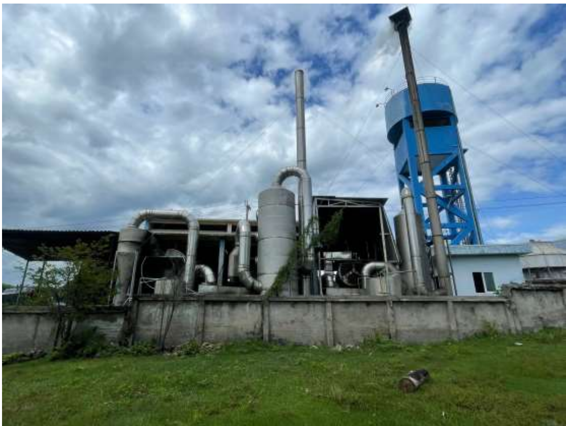
Hình 3.14: Lò hơi lắp mới
