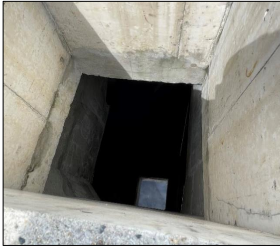
Bể chứa nước ngầm sau xử lý 600m 3
