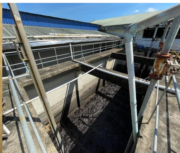
Hình 3. 5 Hình chụp bể xử lý nước thải
