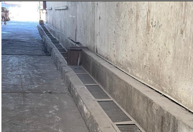
Hình 3. 1 Đường thu gom nước mưa
