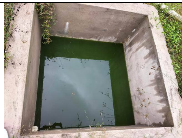
Hình 4.4. Hố gas dẫn nước thải ra bể Biogas
