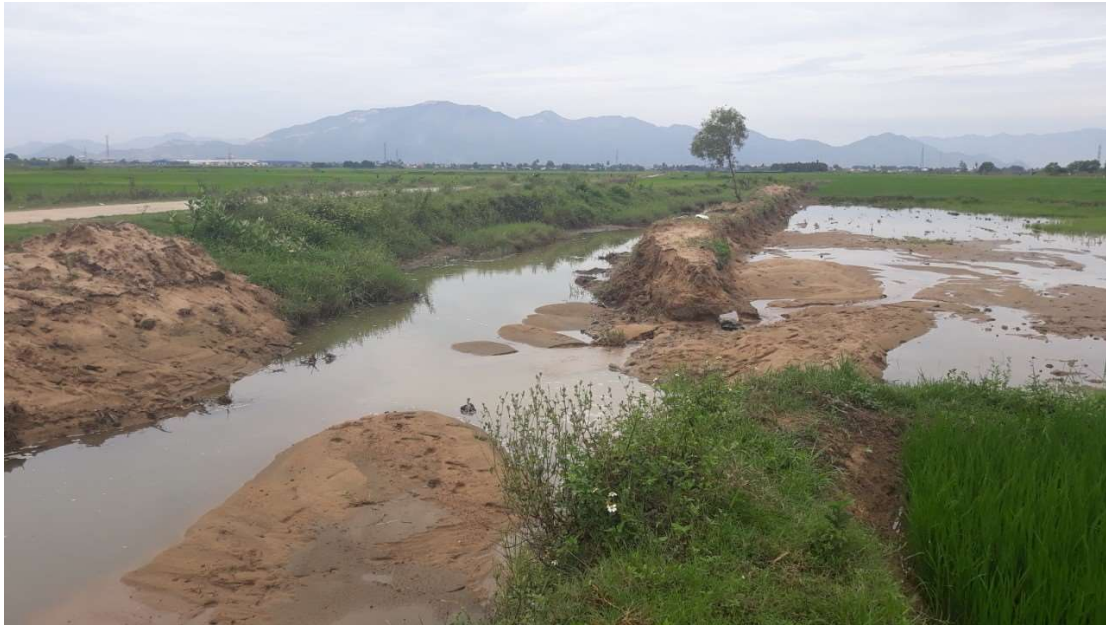
Hình 1: Sạt lở bờ kênh
