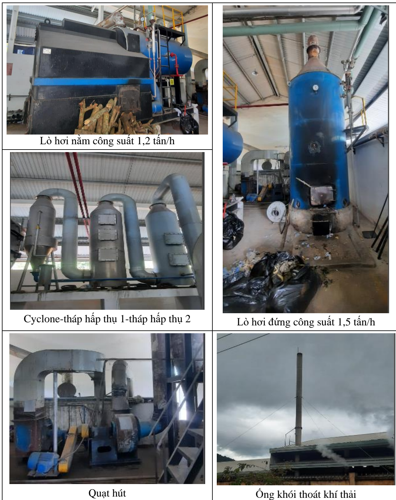
Hình 3. 8 Một số hình ảnh công trình xử lý khí thải lò hơi
