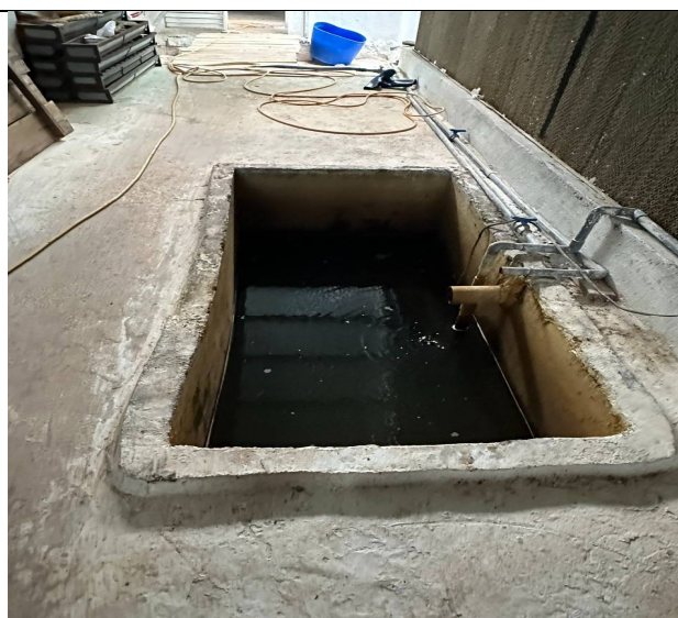
Hình 1.5. Bể chứa nước làm mát
