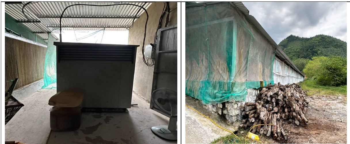
Hình 3.10. Vị trí đặt máy phát điện dự phòng
