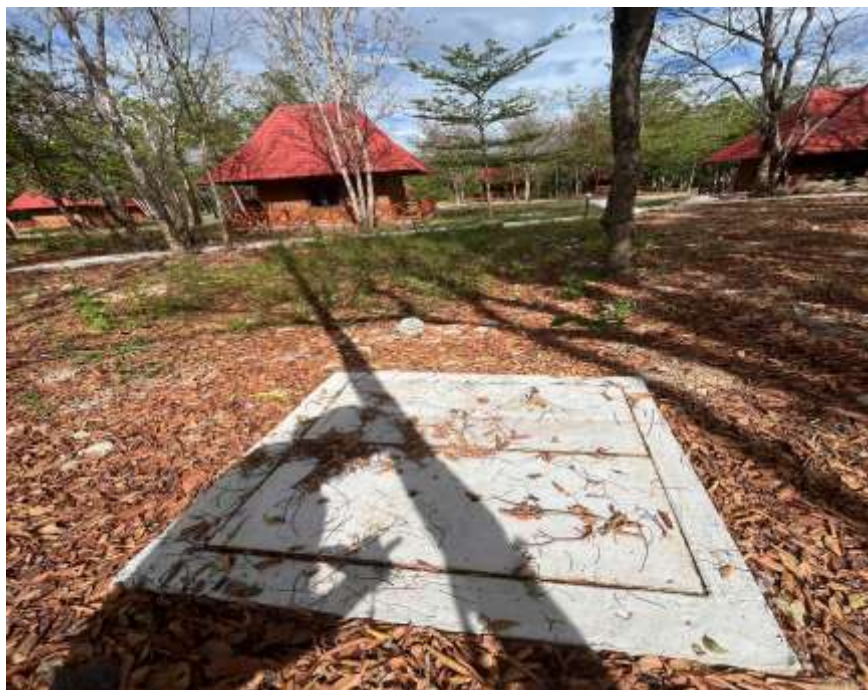
Hình 3-4: Bể chứa xử lý nước thải sinh hoạt.
