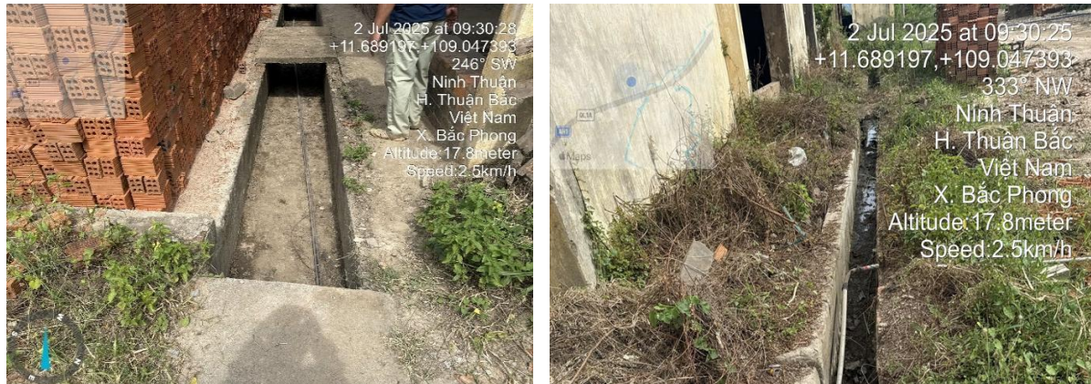
Hình 3.2: Mương thoát nước mưa của cơ sở
