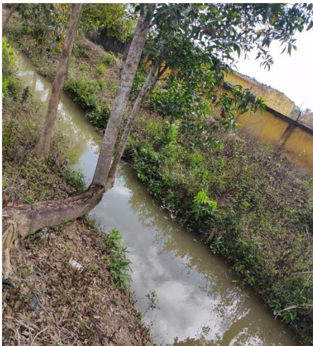
Mương đất dẫn nước đoạn sau Tiểu đoàn 460- BCHQS tỉnh Khánh Hòa
