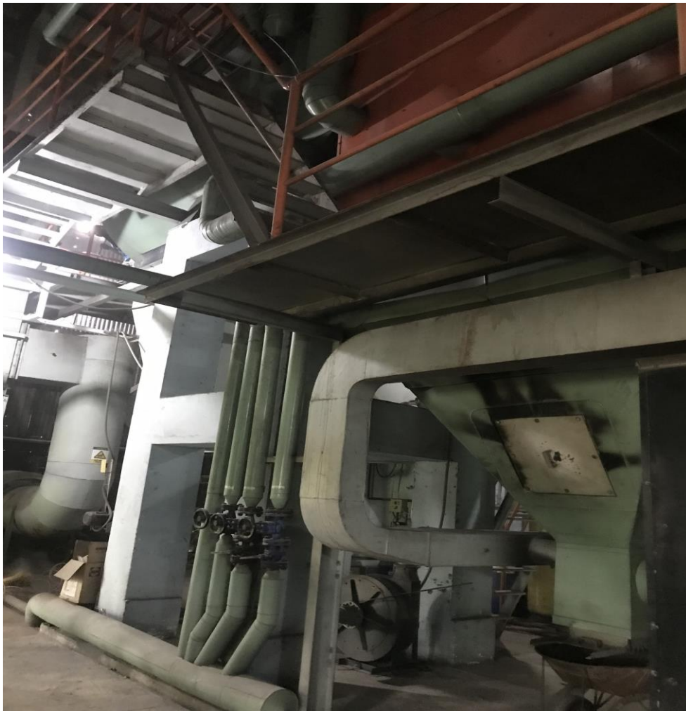
Hình 1. 10 Hệ thống lò hơi đốt bằng trấu nghiền
