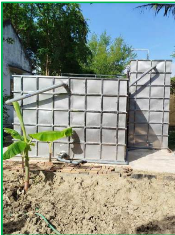
Bể Aerotank và bể MBR
