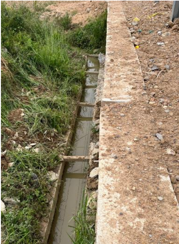
Mương bê tông dẫn nước tưới dọc QL 27C (đoạn đối diện dự án)
