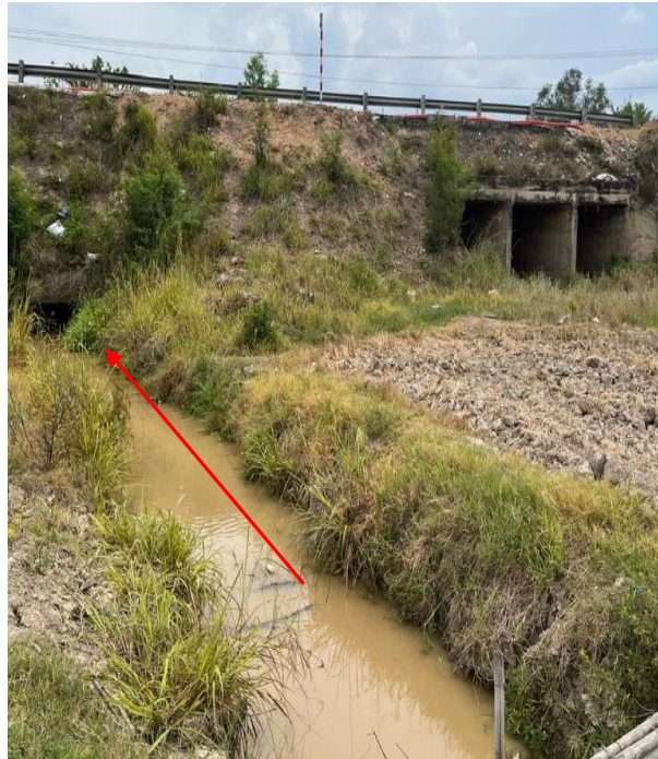
Cống băng đường QL 27C và cống thoát lũ QL 27C
