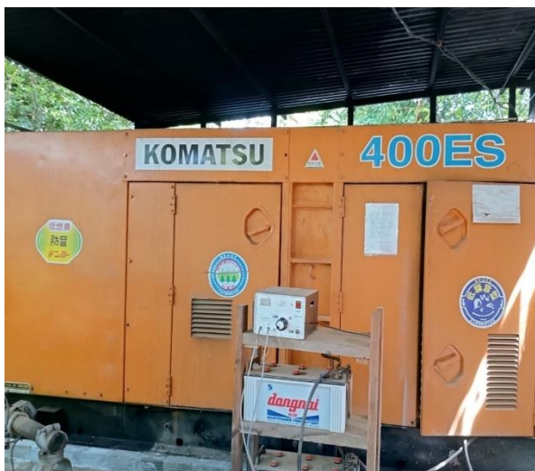
Máy phát điện
