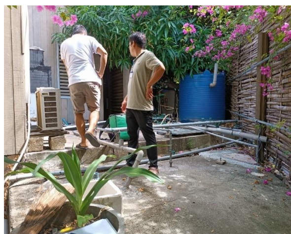
Hệ thống xử lý nước thải
