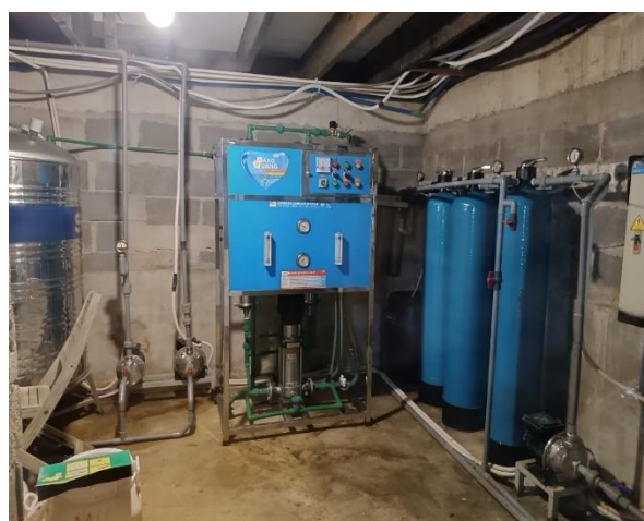
Hệ thống lọc nước
