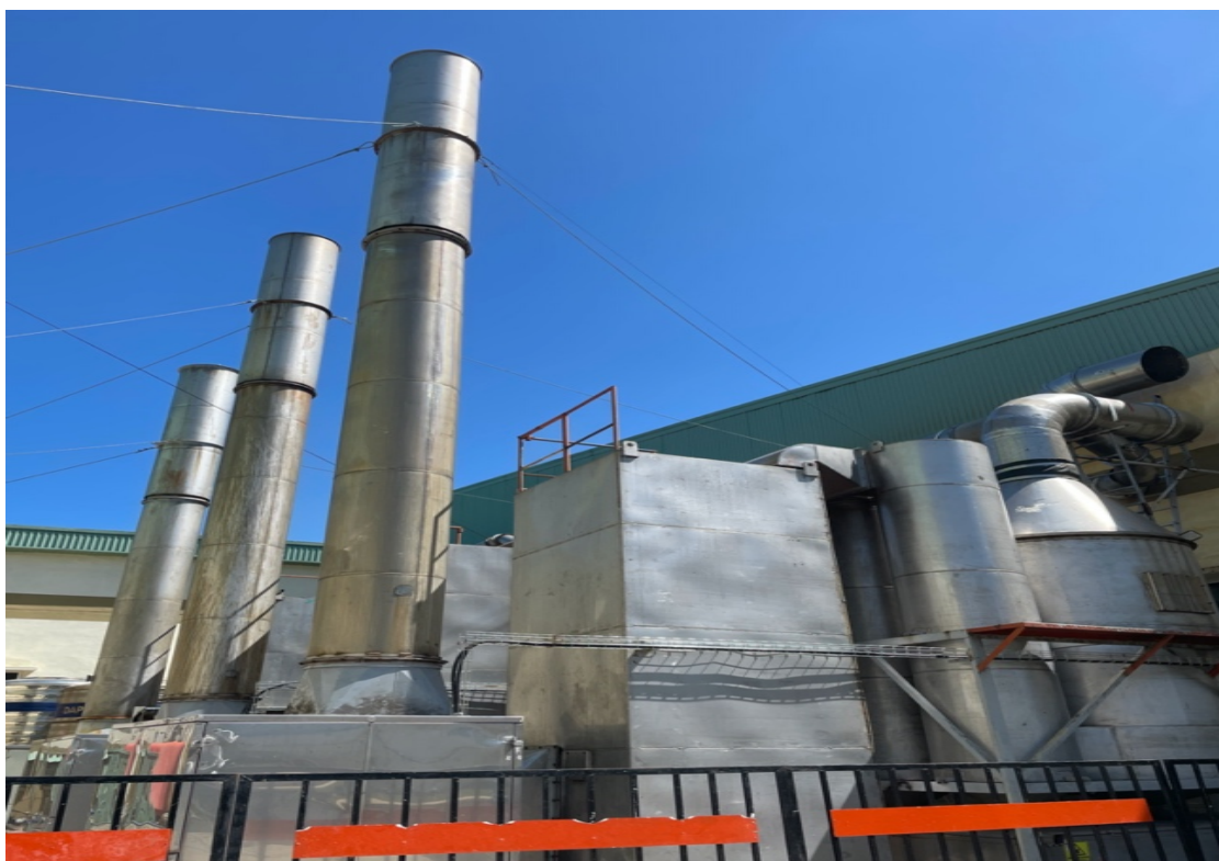
Hình 10. Hệ thống xử lý mùi, bụi Phân xưởng 1
