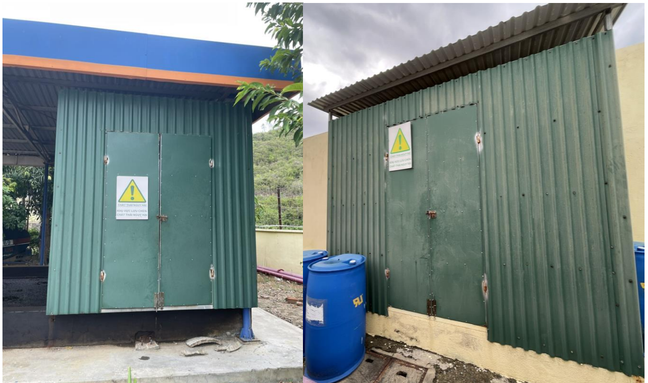
Hình 3.10: Kho chứa chất thải nguy hại tại kho A và kho B
