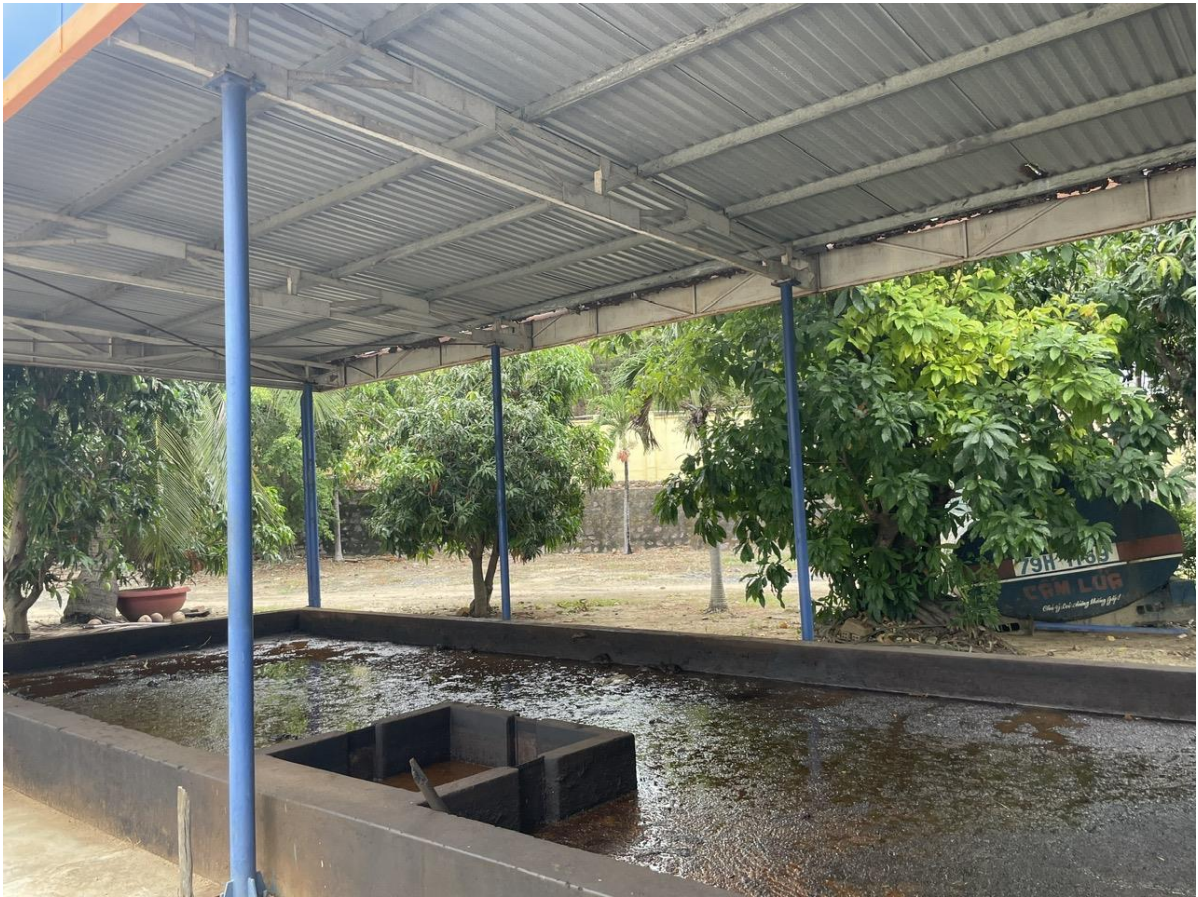
Hình 3.9: Hồ phơi bùn thải nguy hại tại cơ sở
