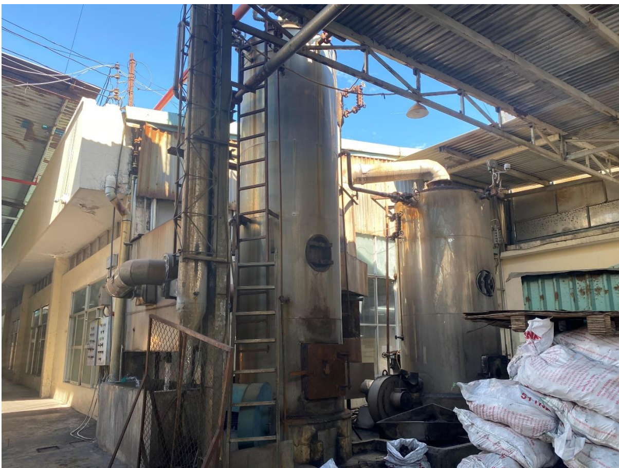
Hình 3. 6 Hình ảnh 02 lò hơi tại cơ sở
