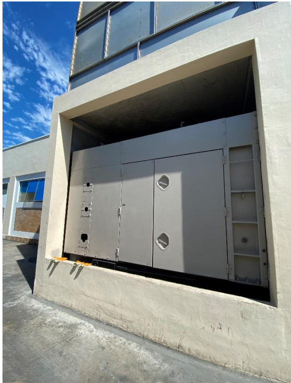
Nhà chứa máy phát điện
