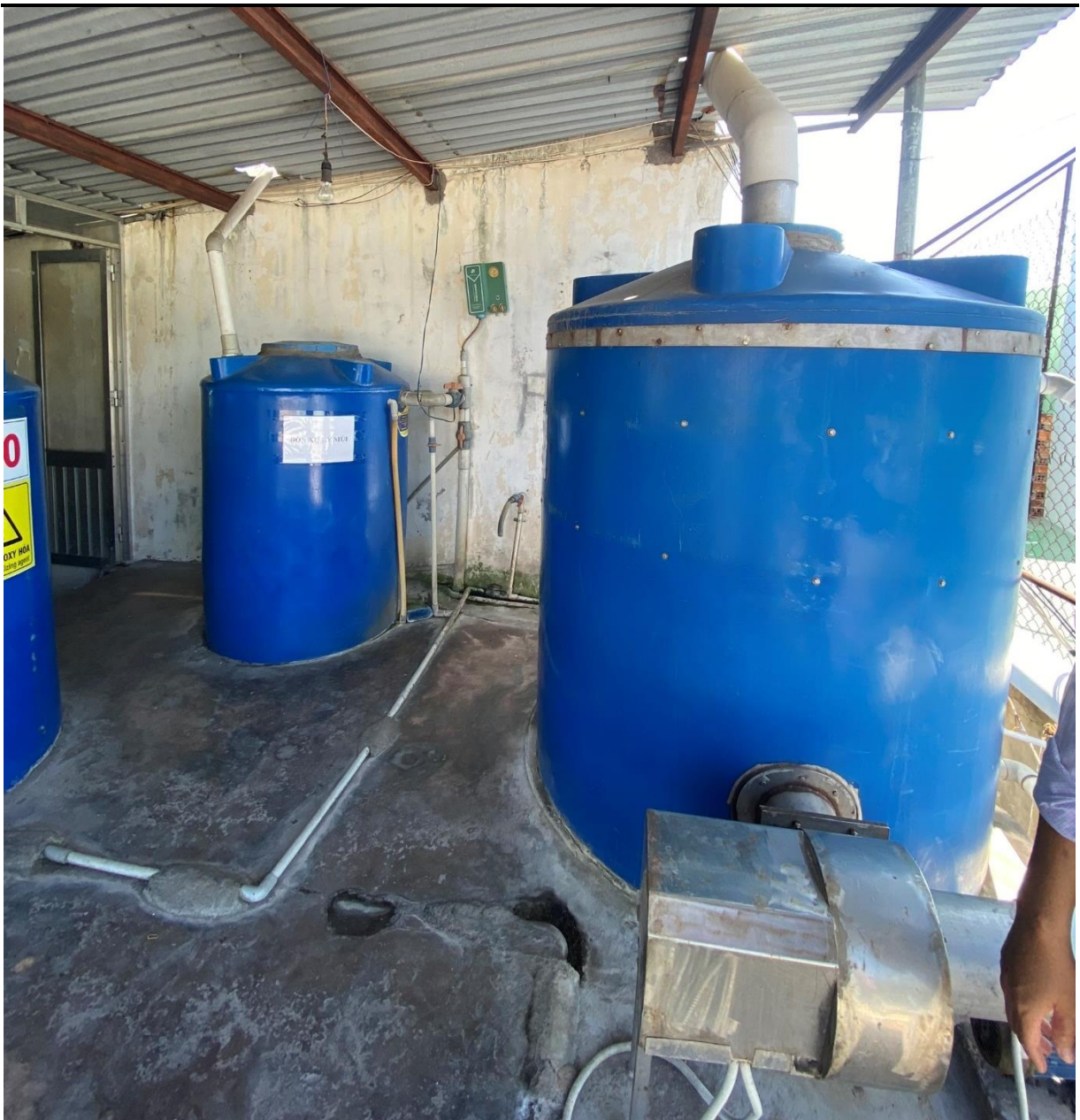
Hình 3. 7 Bồn xử lý mùi của HTXL nước thải
