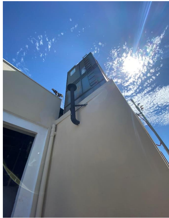
Ống khói máy phát điện
