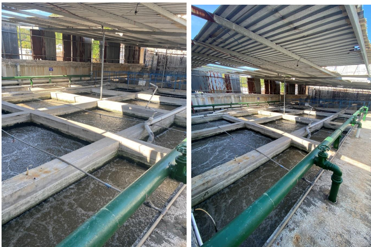
Hình 3. 4 Hiện trạng hệ thống XLNT tại cơ sở
