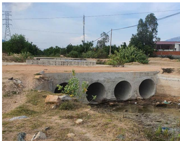
Cống thoát nước về kênh tiêu lũ dọc QL1A
