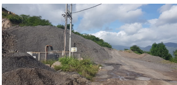
Trạm biến áp
