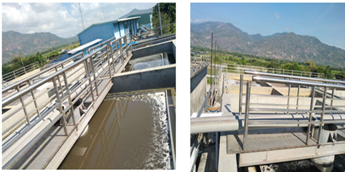
Hình 3.10: Các bể xử lý nước thải
