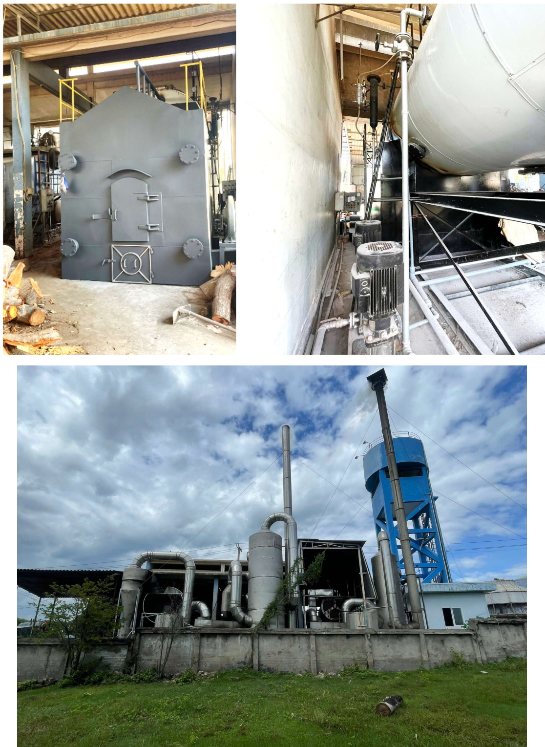
Hình 3.14: Lò hơi lắp mới
