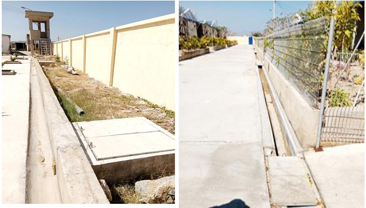
Hình 3.2. Hình ảnh rãnh thu gom nước mưa Khu B.
