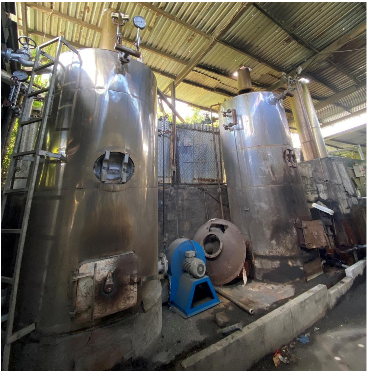
Hình 3. 7 Hình ảnh 02 nồi hơi tại cơ sở
