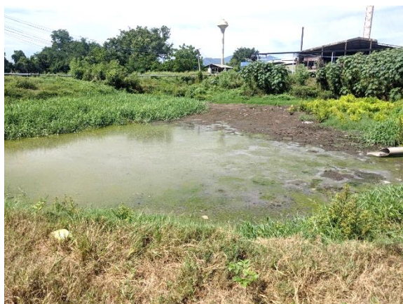
Hình 3.6: Bể lắng cát
