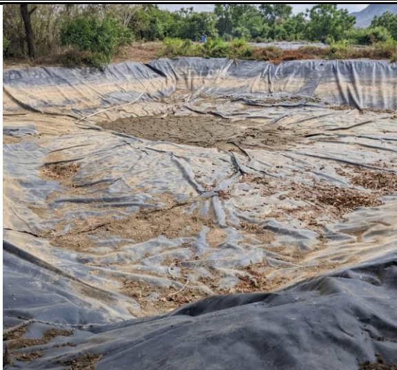
Hình 3.30: Bể chứa bùn
