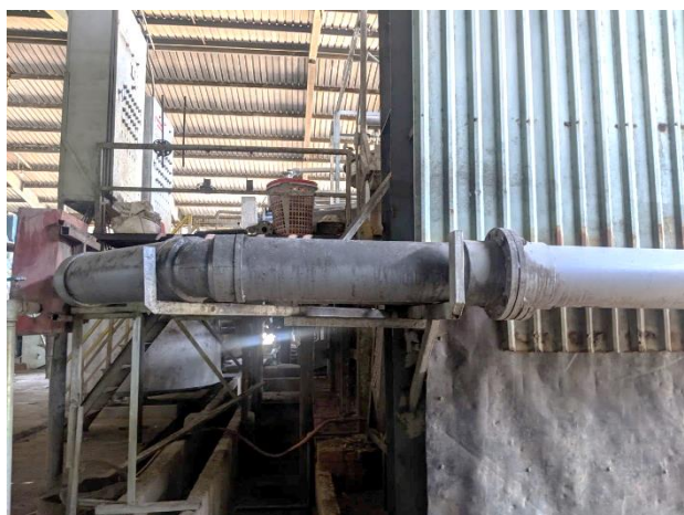
Hình 3.8: Ống kẽm D220 thu gom nước thải công nghệ
