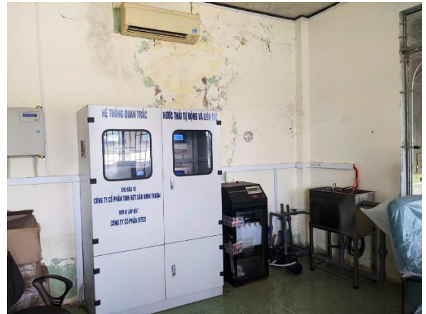
Hình 3.22: Nhà trạm điều khiển quan trắc tự động, liên tục
