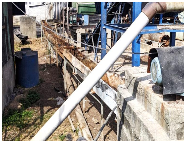
Hình 3.9: Mương bằng thép thu gom nước thải công nghệ vào hầm biogas
