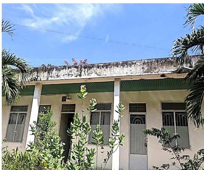
Hình 3.3: Thu gom, thoát nước mưa mái nhà điều hành
