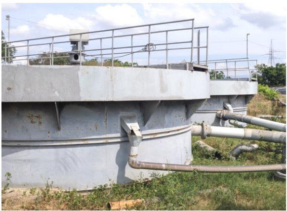
Hình 3.20: Bể lắng bùn hóa lý
